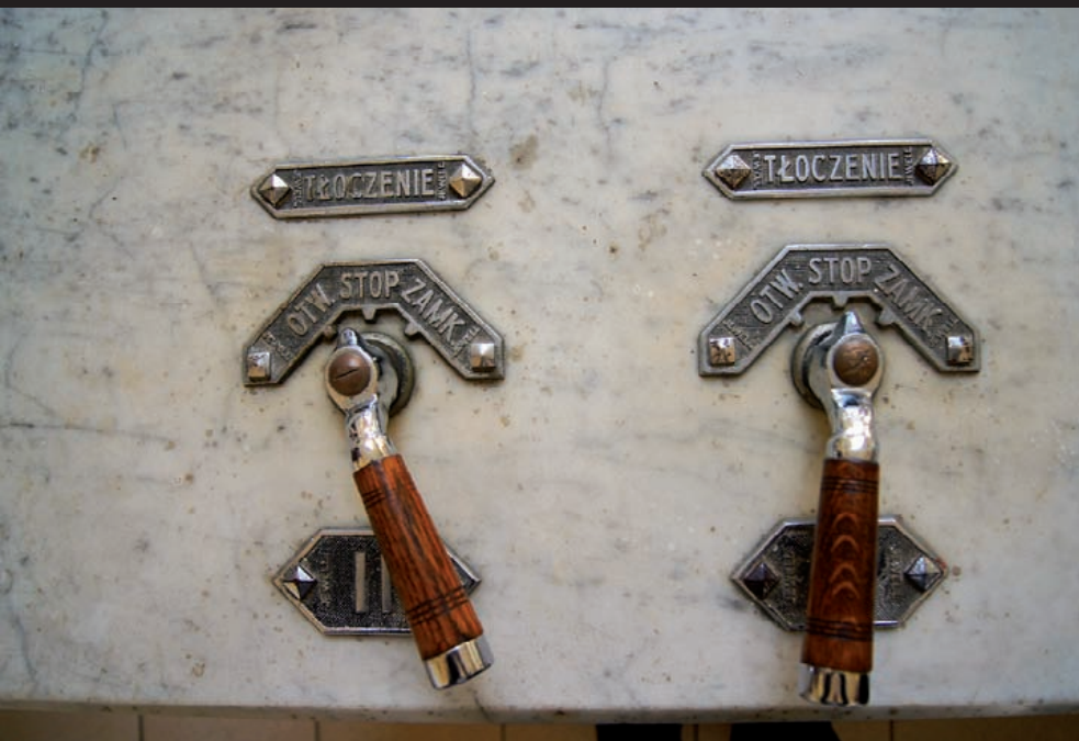
Szafa sterownicza w Zakładzie Filtrów Pośpiesznych (fot. Michał Krasucki)
