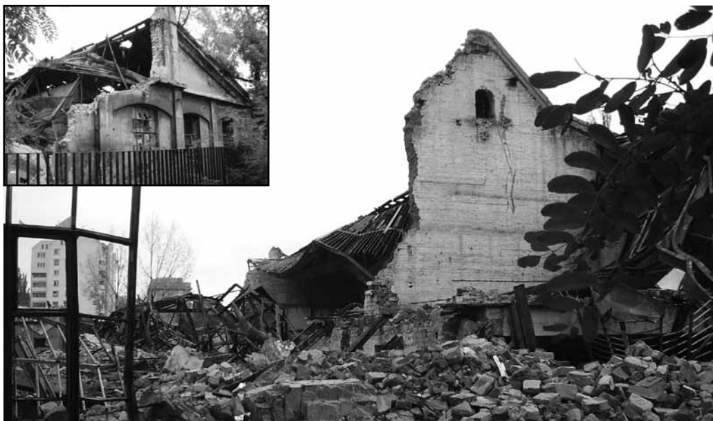
Zniszczenia parowozowni dokonane przez firmę rozbiórkową (fot. J. Sujecki)
