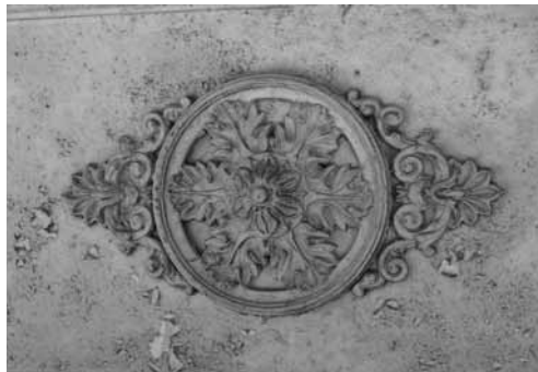
Ozdoba na spodzie płyty balkonowej. (fot.K. Jaszczyński)
