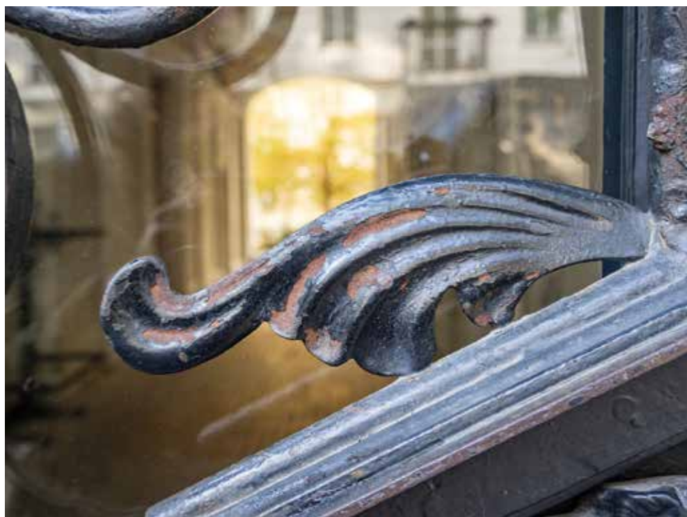
Odspajanie się powłoki lakierniczej na wrotach bramy kamienicy przy ul. Wilczej 22 – wadliwe przygotowanie powierzchni przed malowaniem. Fot. K. Diks
