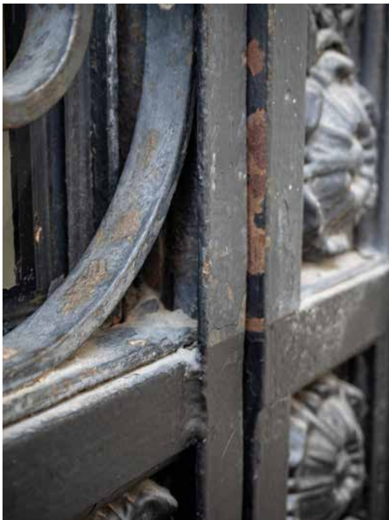
Odszparowanie powłoki lakierniczej na wrotach bramy kamienicy przy ul. Wilczej 22 – nieodpowiednie przygotowanie powierzchni przed malowaniem. Fot. K. Diks
