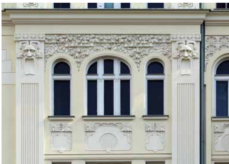
Secesyjny detal elewacji kamienicy w Al. Jerozolimskich 47 (1905-1906, proj. Ludwik Panczakiewicz). Fot. J.S. Majewski
