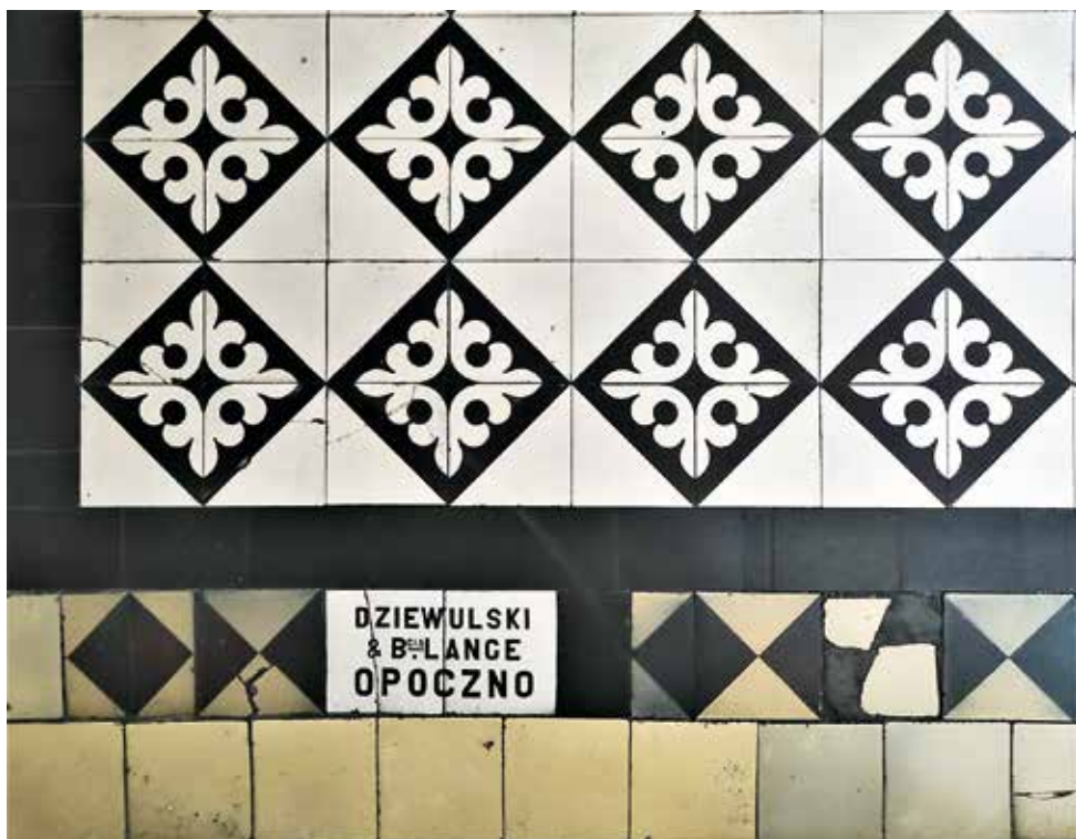
Posadzka w budynku ob. DPS Towarzystwa Przytułku św. Franciszka Salezego, ul. Solec 36A, jedna z najstarszych warszawskich realizacji przedsiębiorstwa J.A. Dziewulskiego, W. Langego i J.B. Langego, z ok. 1897-98 r. Fot. K. Komar-Michalczyk (tu i dalej: jeśli nie wskazano inaczej, zdjęcie wykonano w 2024)
