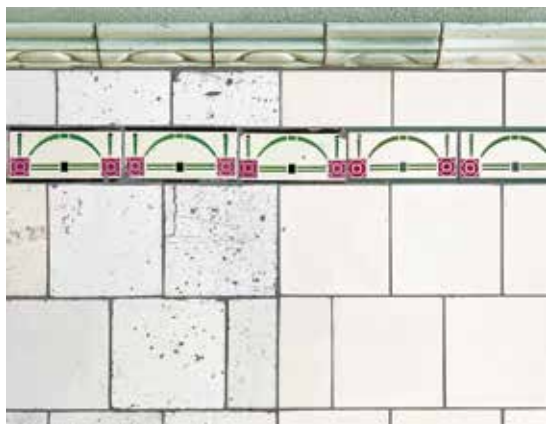
Okładzina ceramiczna ścian przejazdu bramnego kamienicy przy ul. Brzeskiej 18 – po prawej stronie kadru płytki współczesne na wzór pierwotnych. Fot. W. Kmieć
