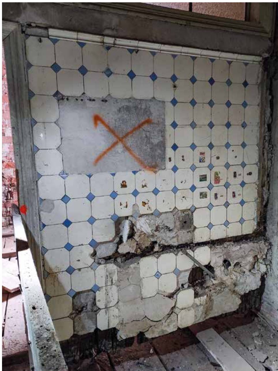
Okładzina ścian łazienki w kamienicy przy ul. Jasnej 17 po „remontie” z l. 2023-2024, w trakcie którego realizacja została zniszczona. Fot. K. Komar-Michalczyk
