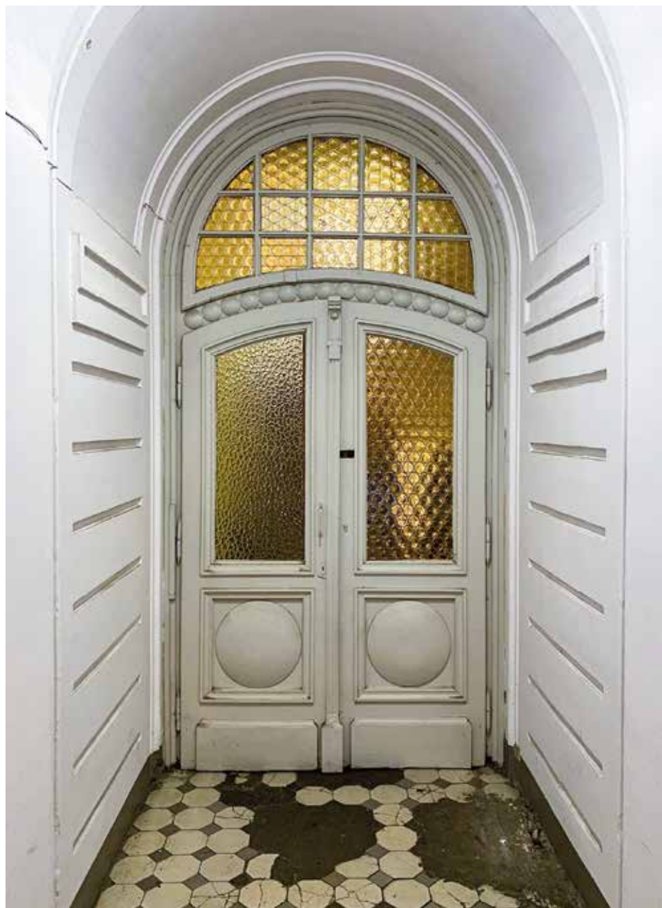
Uzupełnione wylewką betonową miejsca ubytków po płytkach – kamienica przy ul. Brackiej 18. Fot. W. Kmieć
