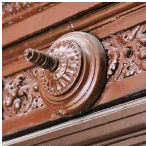
Odcięta rurka gazowa w obramieniu drzwi do jednego z mieszkań w kamienicy przy ul. Hożej 27. Fot. J.S. Majewski
