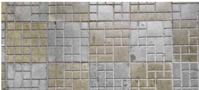
Nawierzchnia przejazdu bramnego kamienicy przy ul. Widoak 20 – z płytek o wymiarach, i podziałach odbiegających od stosowanych w płytkach historycznych. Fot. K. Komar-Michalczyk, 2021
