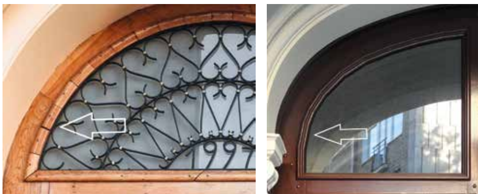
Nadświetle wrót bramnych kamienicy w Al. Jerozolimskich 55 i ul. Wiejskiej 21 – niefachowy sposób wykonania listew mocujących szyby do ramy skrzydła za pomocą krótkich listewek udających półtłuk i łuk koszowy – rozwiązanie pomysłowe, ale nieestetyczne. Fot. A. Cichy
