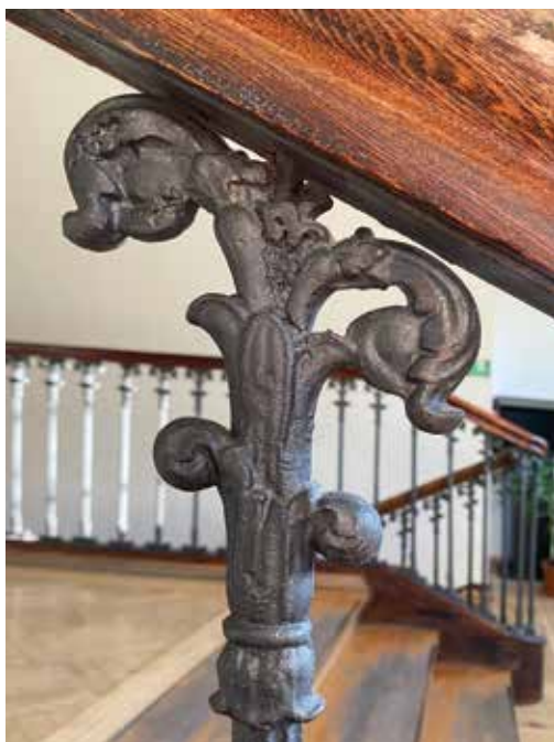
Fragment balustrady schodów klatki schodowej gmachu d. Szkoły Głównej (ob. Wydz. Archeologii UW). Czyszczenie strumieniowo-ścierne zmieniło fakturę powierzchni i stępiło krawędzie żeliwnego odlew. Fot. W. Kmieć
