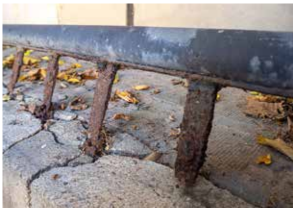
Fragment ogrodzenia przy Pałacu Staszica od strony ulicy Kopernika – zniszczenie korozyjne obiektu w rezultacie braku działań zabezpieczających. Fot. K. Diks
