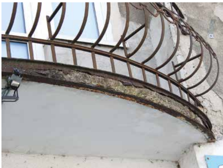
Zniszczona konstrukcja nośna balustrady balkonu domu przy ul. Globusowej 7 we Włochach. Fot. W. Weker
